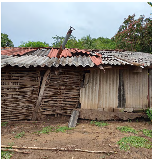
Figura 6.13. Desplazamiento lateral de las paredes de madera
