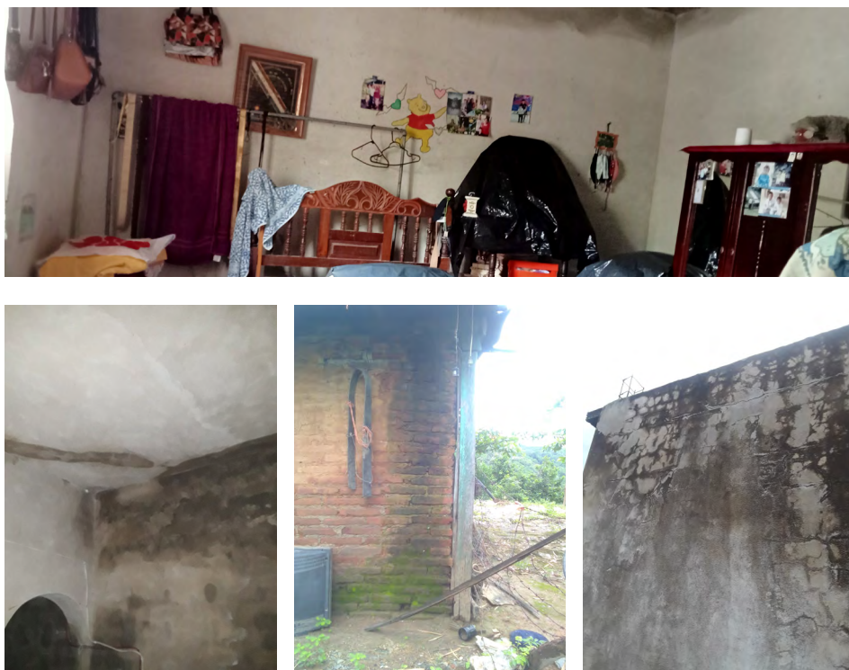
Figura 6.24. Problemas de humedad en muros
