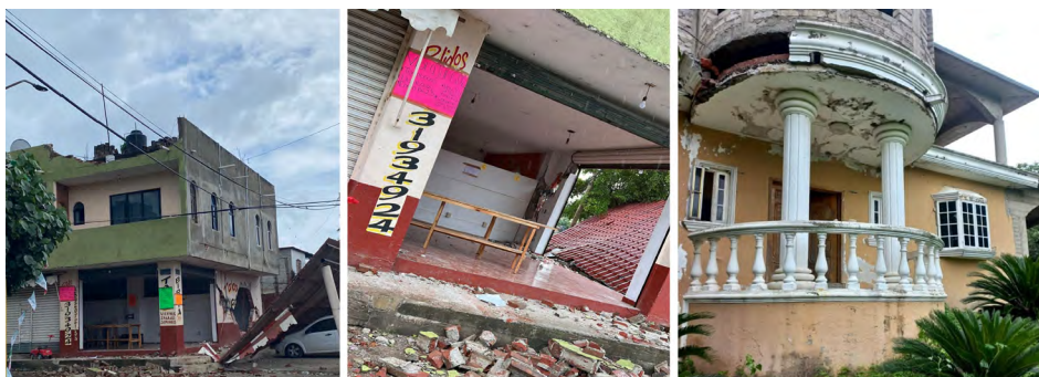
Figura 6.27. Caída de pretilos y ornamentos de fachada
