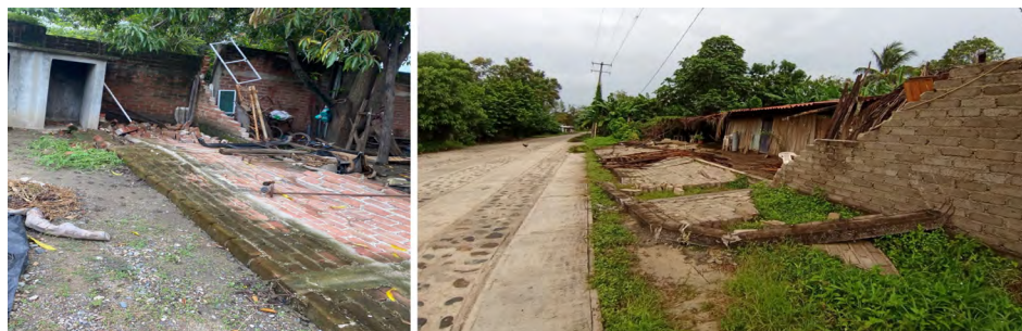
Figura 6.28. Caída de muros perimetrales de terrenos
