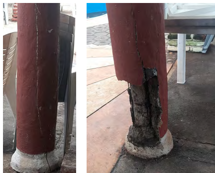
Figura 6.20. Falla por compresión en columnas de concreto
