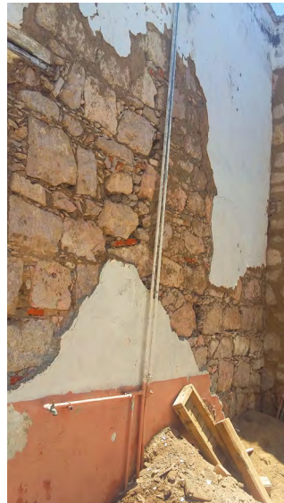
Figura 3. Perdida de juntas en el muro por falta de aplanado
