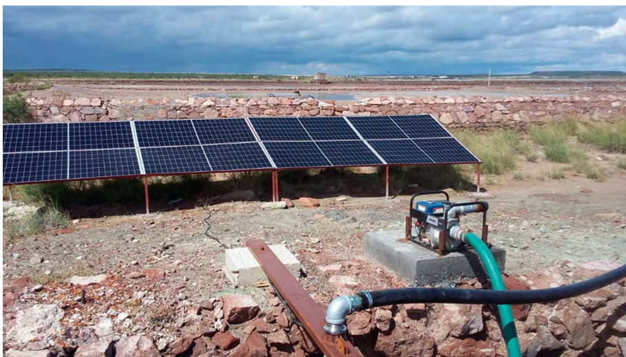
Figura 8.1. Bomba eléctrica para la extracción de salmuera de la laguna de Salinas
