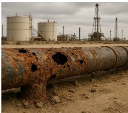
Figura 5.1. Tubería corroída en la industria del petróleo
