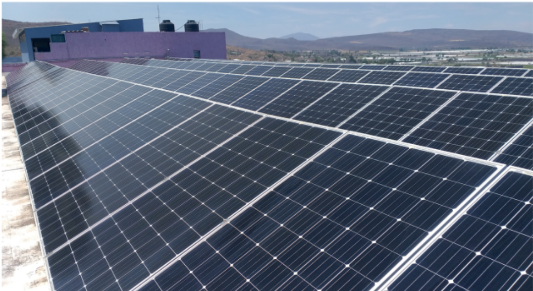
Figura 2. Granja solar área de techo
