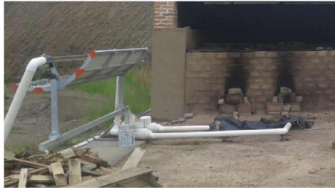
Figura 8. Sistema de inyección de aire caliente
