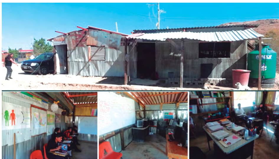
Figura 1. Condiciones de la infraestructura física de la Telesecundaria de Galea
