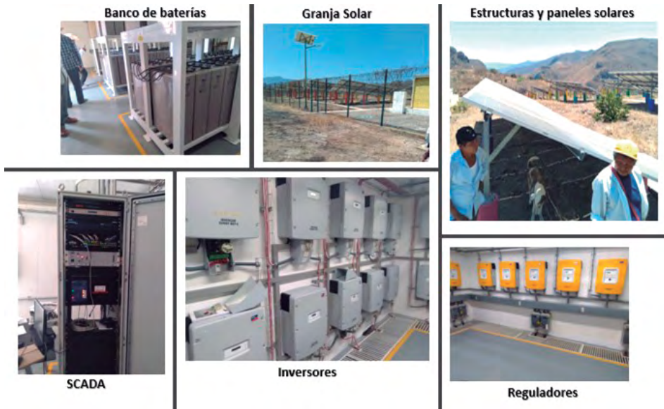
Figura 6. Equipamiento del sistema solar fotovoltaico de Potrero de la Palmita, Nayarit, México
