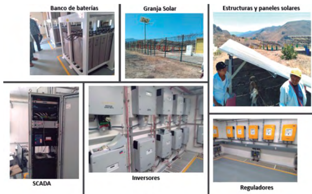
Figura 6. Equipamiento del sistema solar fotovoltaico de Potrero de la Palmita, Nayarit, México
