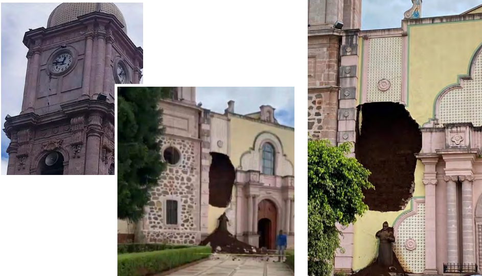
Figura 5.11. Daños estructurales en la fachada de la Parroquia de San Miguel Arcángel, Tacátzcuaro
