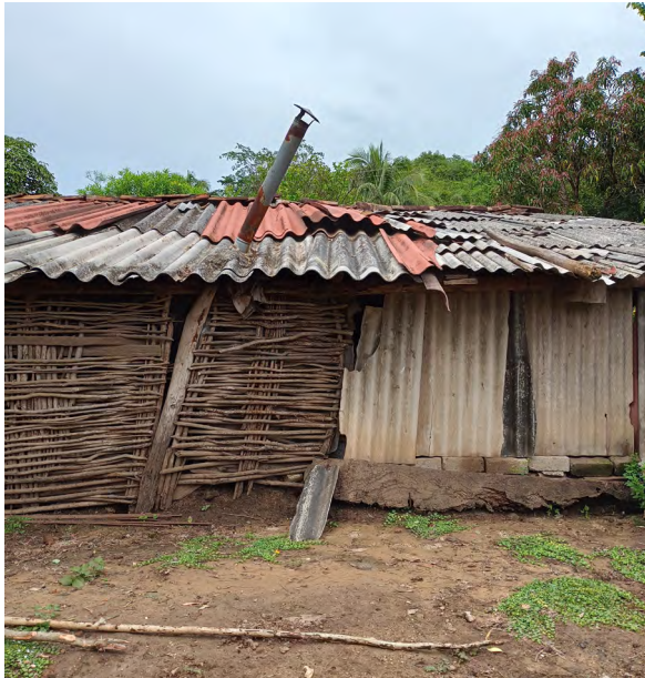
Figura 6.13. Desplazamiento lateral de las paredes de madera
