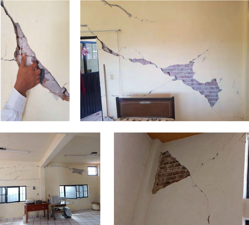
Figura 5.16. Vista interior de los daños estructurales en muros de los dormitorios
