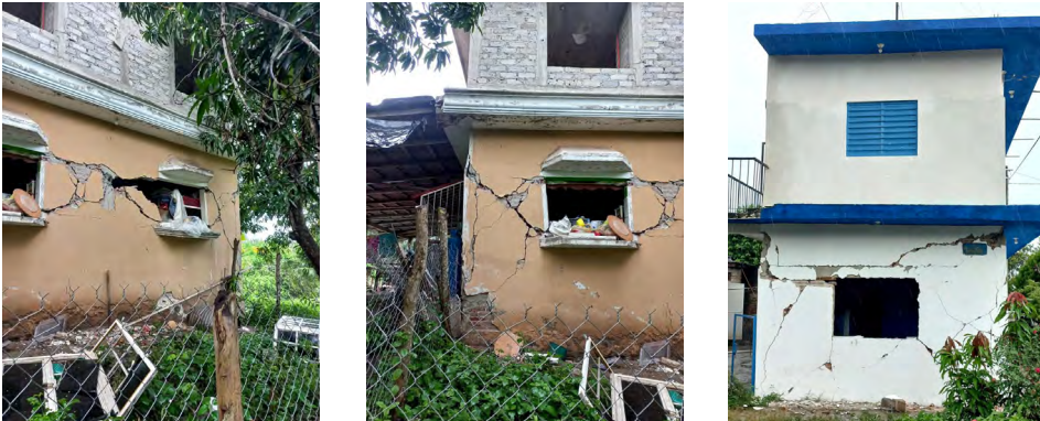
Figura 6.19. Muros de mampostería sin confinamiento adecuado en puertas y ventanas
