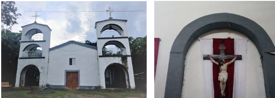
Figura 5.12. Fachada y daños en elementos decorativos, Capilla de Guadalupe del Cobre
