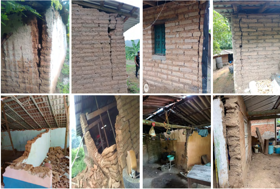
Figura 6.4 .Fallas típicas en muros de mampostería sin castillos en la intersección de muros perpendiculares
