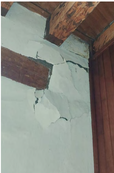
a) Daño en la zona de dintel
