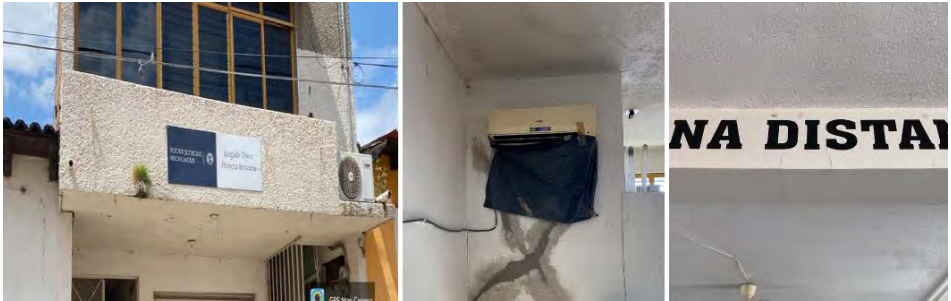
Figura 7.9. Daños observados en Juzgado Mixto de Coalcoman
