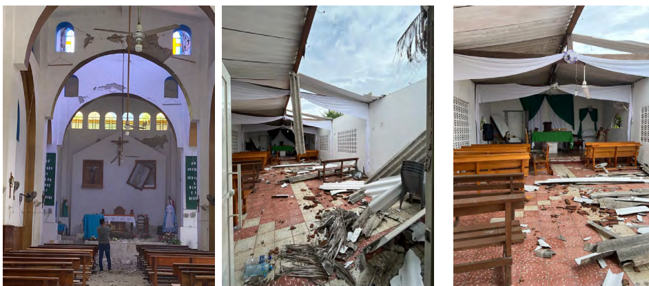
Figura 5.20 .Vista general del interior del templo y daños estructurales
