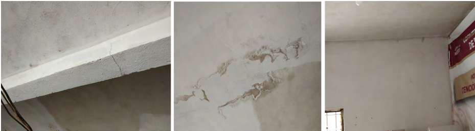
Figura 7.3. Daños observados en la encargatura ubicada en El Coire
