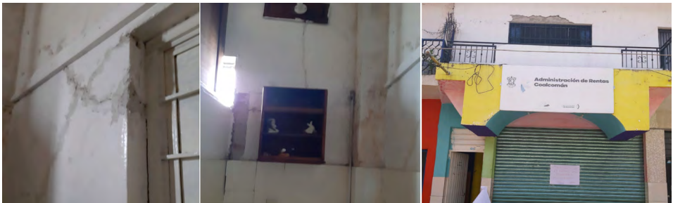
Figura 7.6. Daños observados en Administración de rentas de Coalcomán
