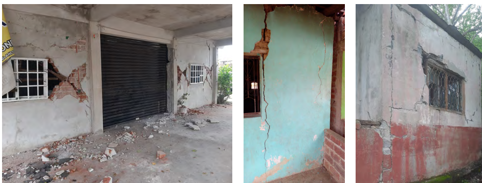
Figura 6.6. Fallas en muros de mampostería sin castillos en aberturas de puertas o ventanas
