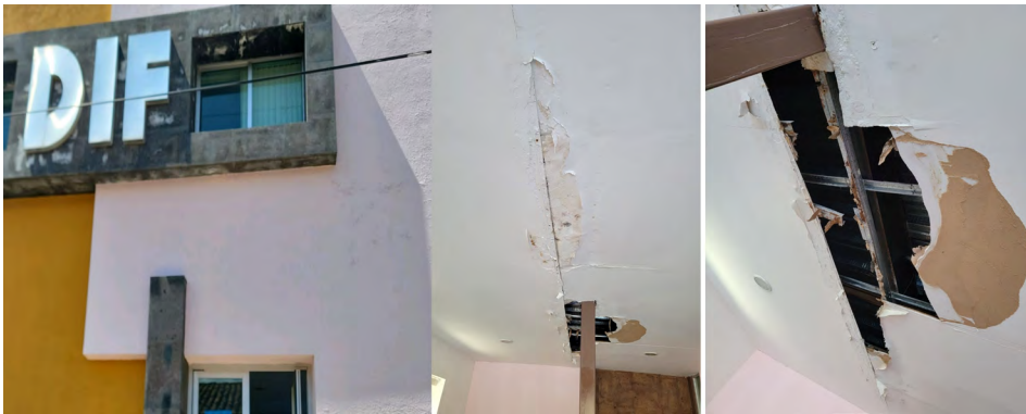
Figura 7.8. Daños observados en DIF municipal de Coalcomán
