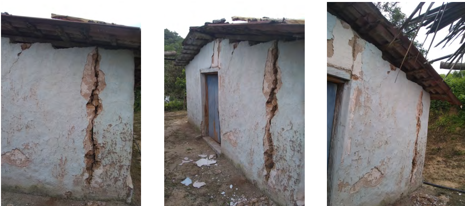
Figura 5.14. Daños estructurales en la capilla Chacalapa, el Coire
