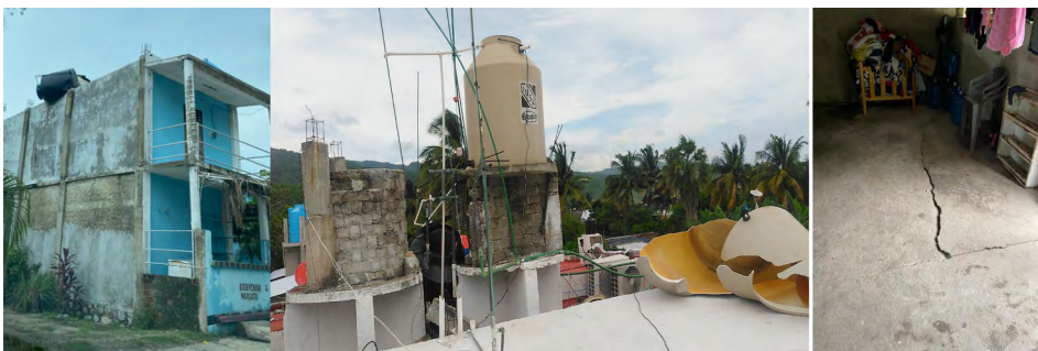
Figura 6.26. Caída de tinacos por falta de sujeción a la base de soporte y agrietamientos de los firmes de piso
