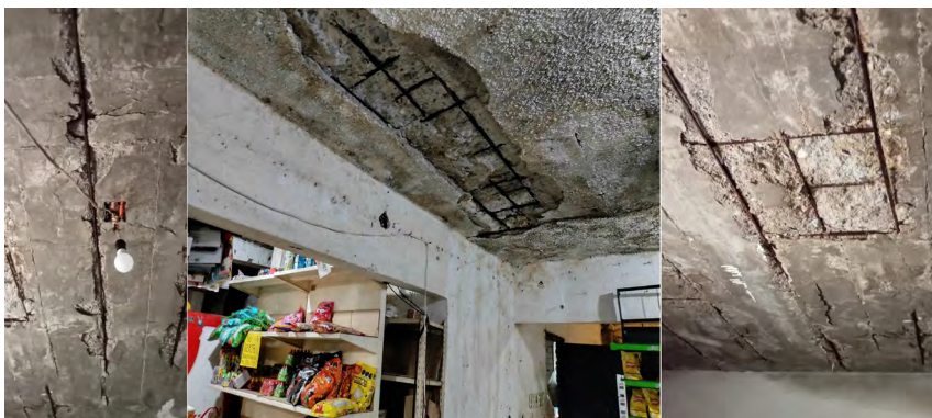
Figura 6.25. Espesor insuficiente del recubrimiento que deja expuesto el acero
