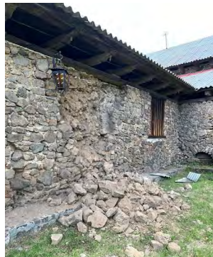
Figura 5.33. Daños en el muro de mampostería de la parroquia Santa Ana
