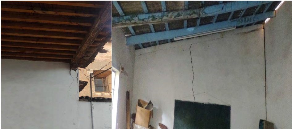
Figura 7.11. Daños observados en edificio CEBA en Pátzcuaro
