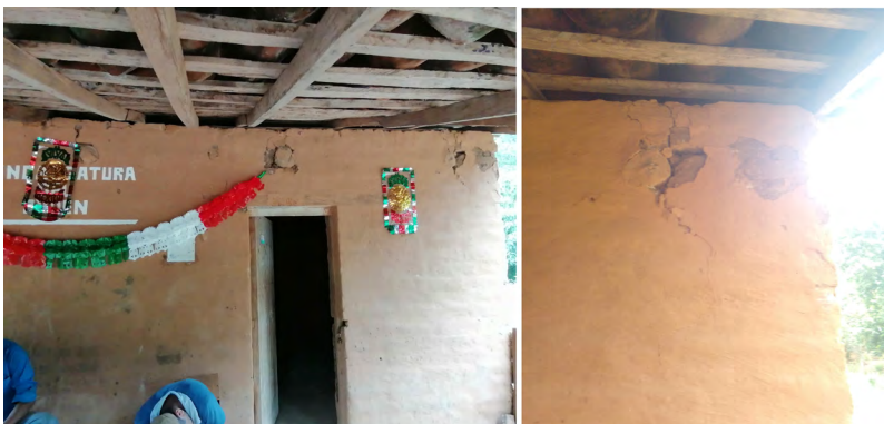
Figura 7.5. Daños observados en la encargatura de Pomaro
