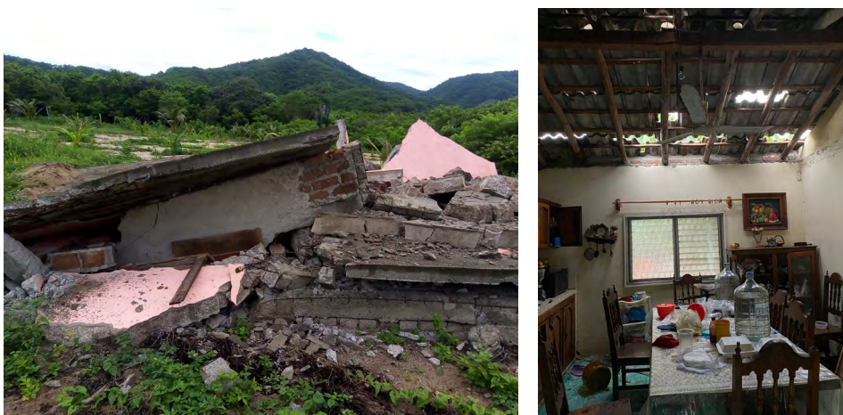
Figura 6.2. Colapso total, parcial y caída de techo de tejas sobre elementos de madera
