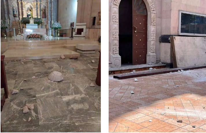
Figura 5.29. Desprendimiento de elementos no estructurales en el interior y exterior del recinto
