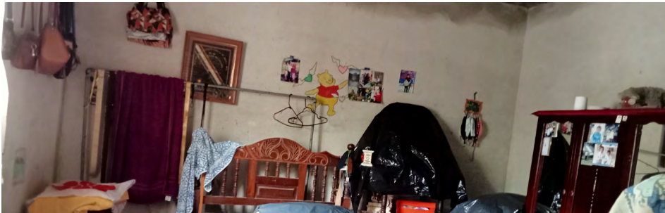
Figura 6.24. Problemas de humedad en muros
