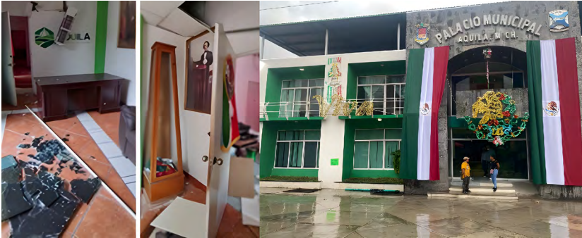
Figura 7.1. Fachada principal y daños no estructurales en el edificio de la ayudantía de Aquila
