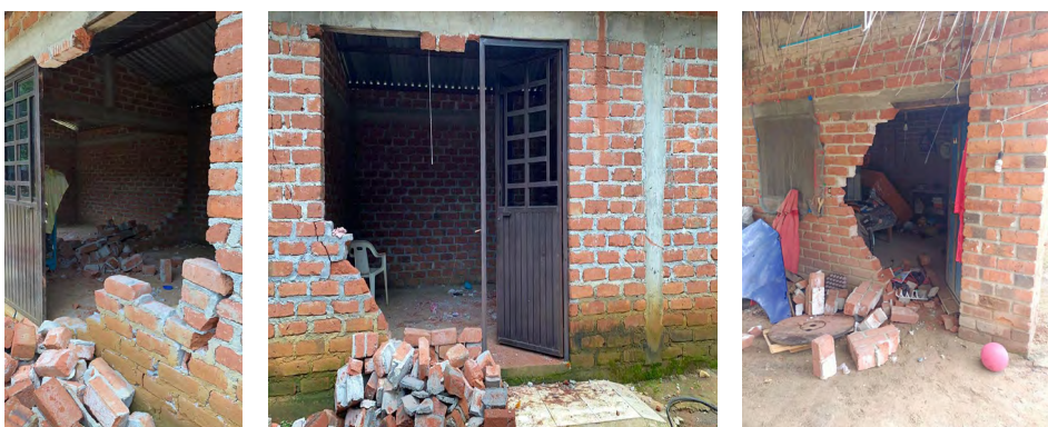
Figura 6.7. Colapso de muros por falta de confinamiento lateral
