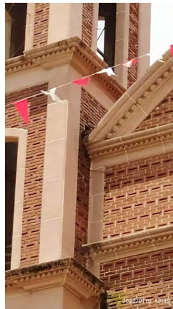
Figura 5.27. Daño por interacción de la fachada con el campanario en el templo San Juan Bautista
