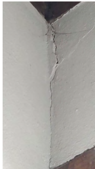
b) Daño en la zona de intersección
