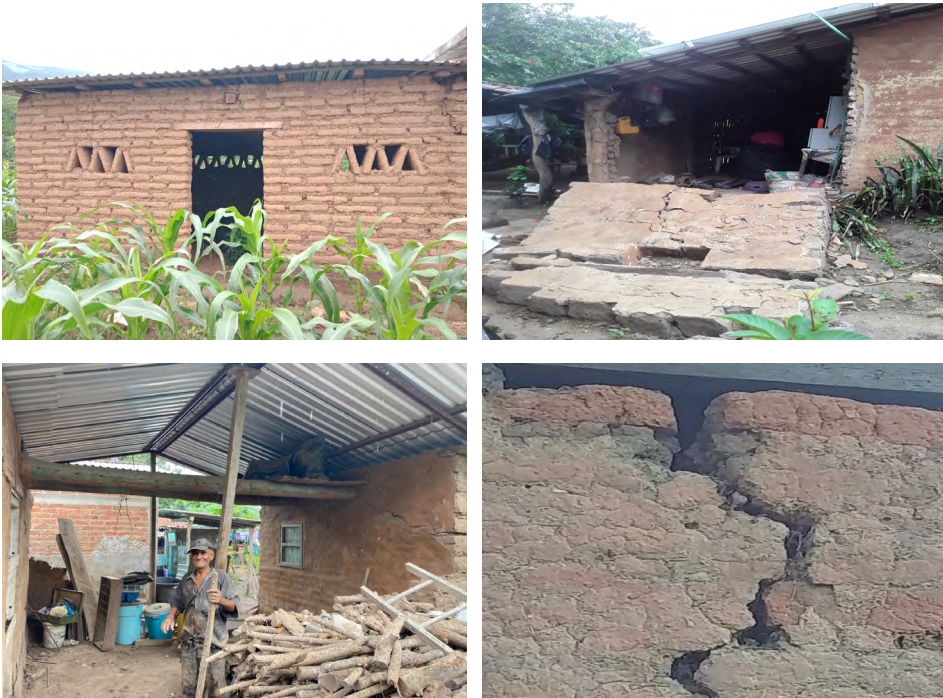
Figura 6.11. Muros de adobe sin confinamiento y daños típicos
