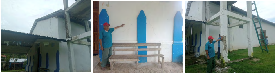
Figura 5.17. Daños estructurales en la capilla de El Coire
