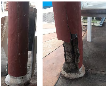
Figura 6.20. Falla por compresión en columnas de concreto
