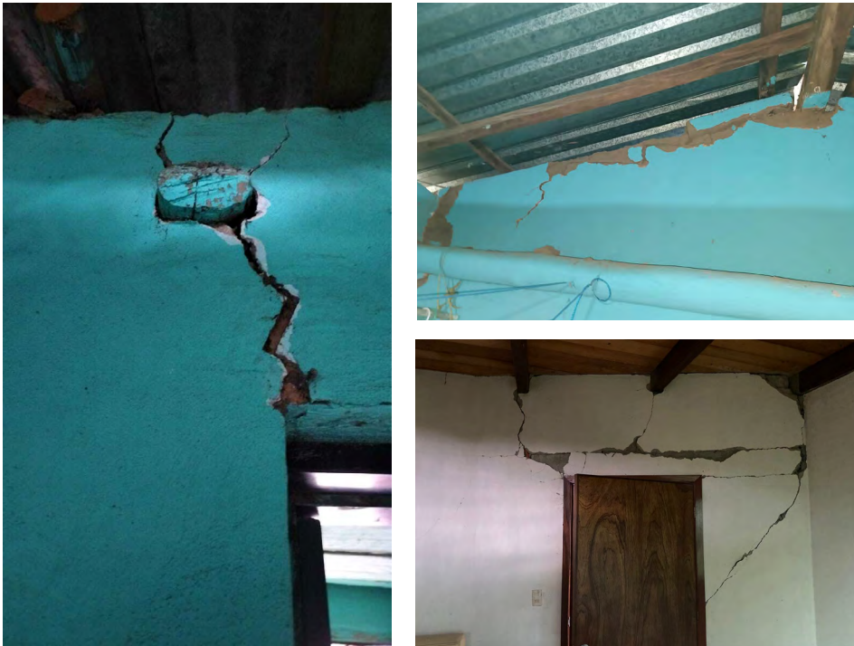
Figura 6.8. Concentraciones de esfuerzo sobre el muro en la zona de apoyo de la viga que soporta el techo
