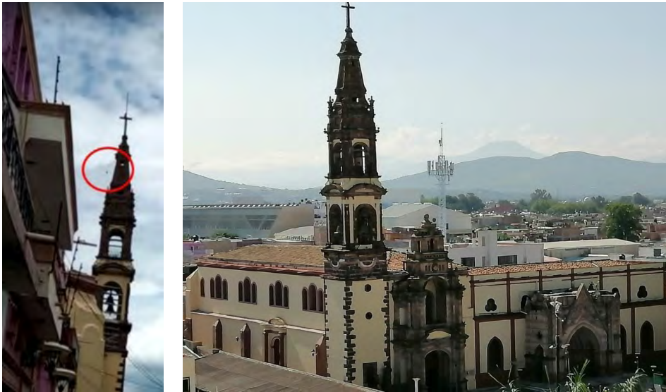
Figura 5.21. Vista general de la fachada principal del templo y desprendimiento de una de sus piezas
