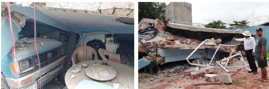
Figura 6.23. Colapso de una vivienda por el incremento de la fuerza cortante en la planta baja flexible, agravado por una deficiente conexión viga-columna.
