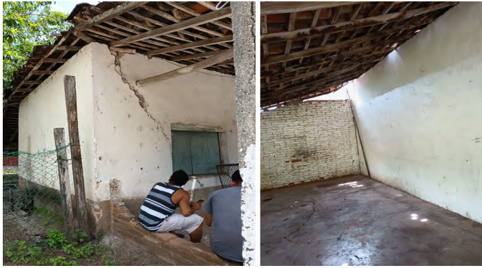
Figura 7.4. Daños observados en la Casa Comunal de Pomaro.
