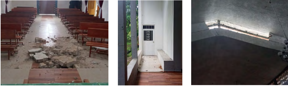
Figura 5.13 .Daños en el interior de la Capilla de Guadalupe del Cobre
