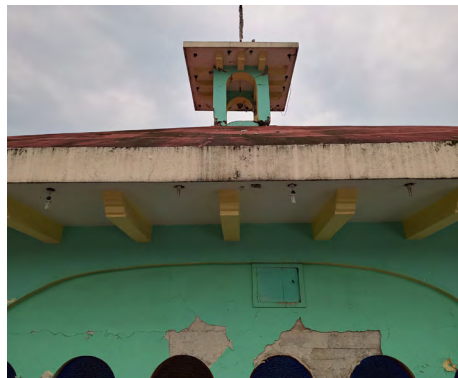
b) Desprendimiento del aplanado y daño en la linternilla
