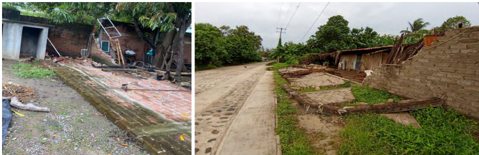
Figura 6.28. Caída de muros perimetrales de terrenos
