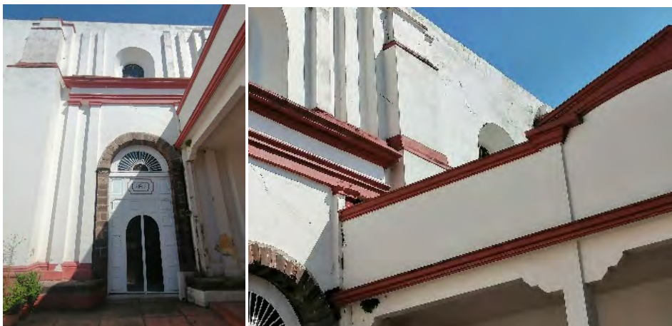
Figura 5.36. Interacción entre el muro pretil y los muros de la fachada del templo
