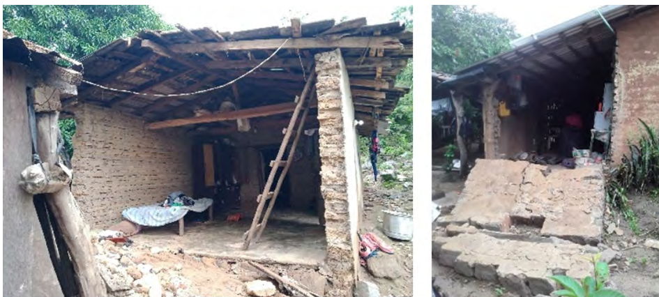
Figura 6.29. Falla de los muros fuera de su plano
