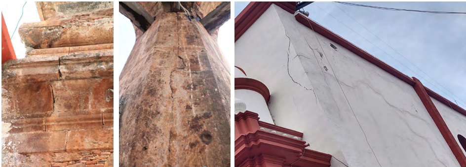
Figura 5.30. Daños menores en cornisas, pilastras y muros laterales
