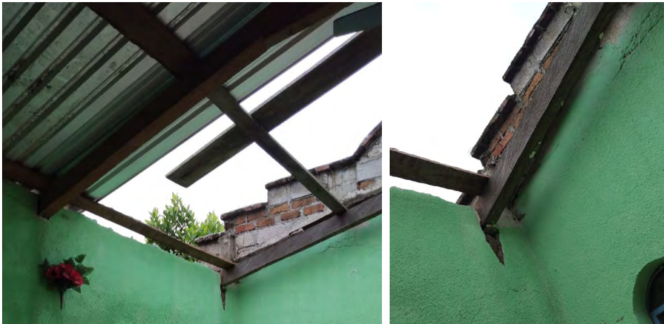
Figura 5.19. Daño estructural en la iglesia de Pueblo Nuevo
