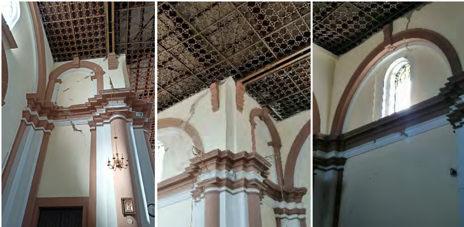
Figura 5.35. Agrietamiento en la zona de transepto y de la cubierta
