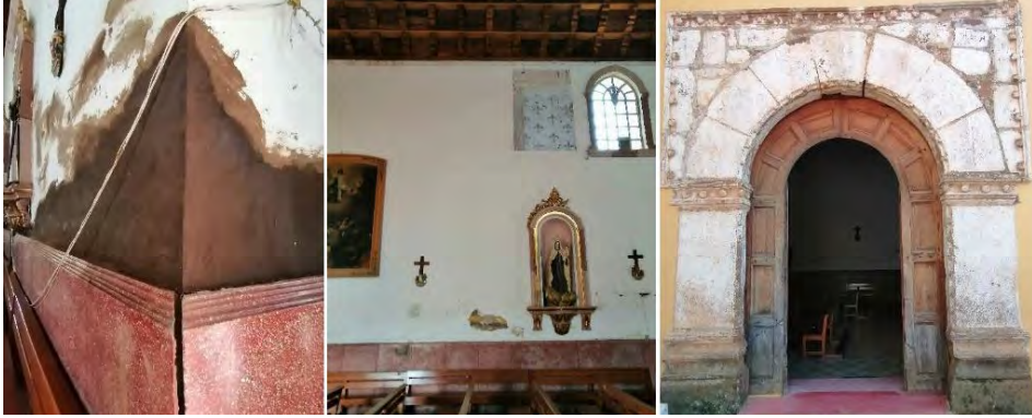
Figura 5.26 .Detalles de los daños en la Parroquia de Santiago Apóstol
