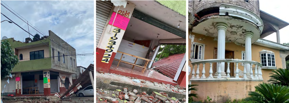
Figura 6.27. Caída de pretilos y ornamentos de fachada
