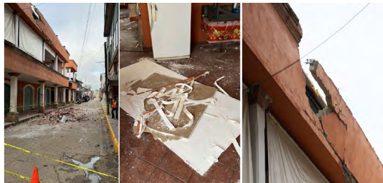
Figura 7.10. Daños observados en el Mercado de Coalcomán
