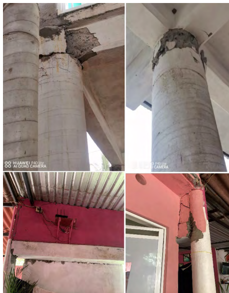
Figura 6.22. Fallas en la zona de conexión por falta de estribos, anclaje del acero, adherencia, falta de continuidad del acero longitudinal y bajas cuantías de acero
