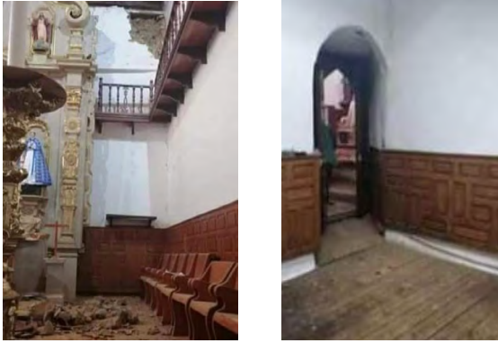
Figura 5.32. Desprendimiento de aplanados de muros
