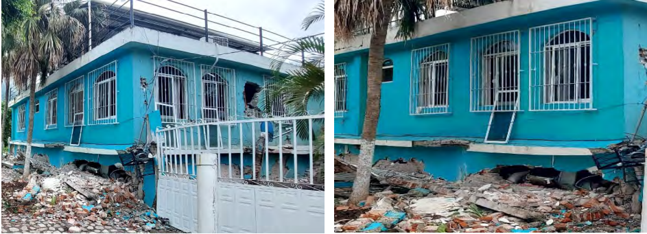
Figura 6.18. Falla de los muros de la planta baja de una vivienda de dos niveles
