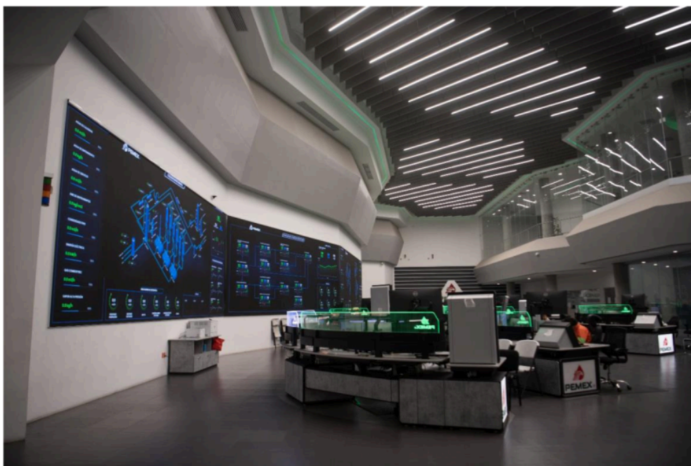
Fuente: SENER, Refinería Dos Bocas. Centro de mando
