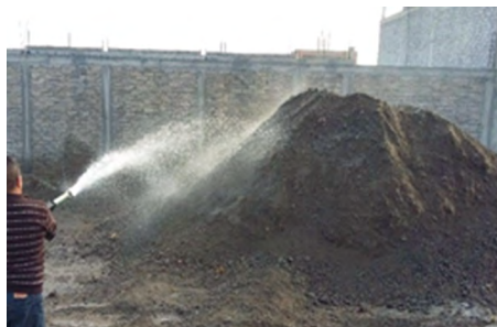
Figura 17. Incorporación de humedad
